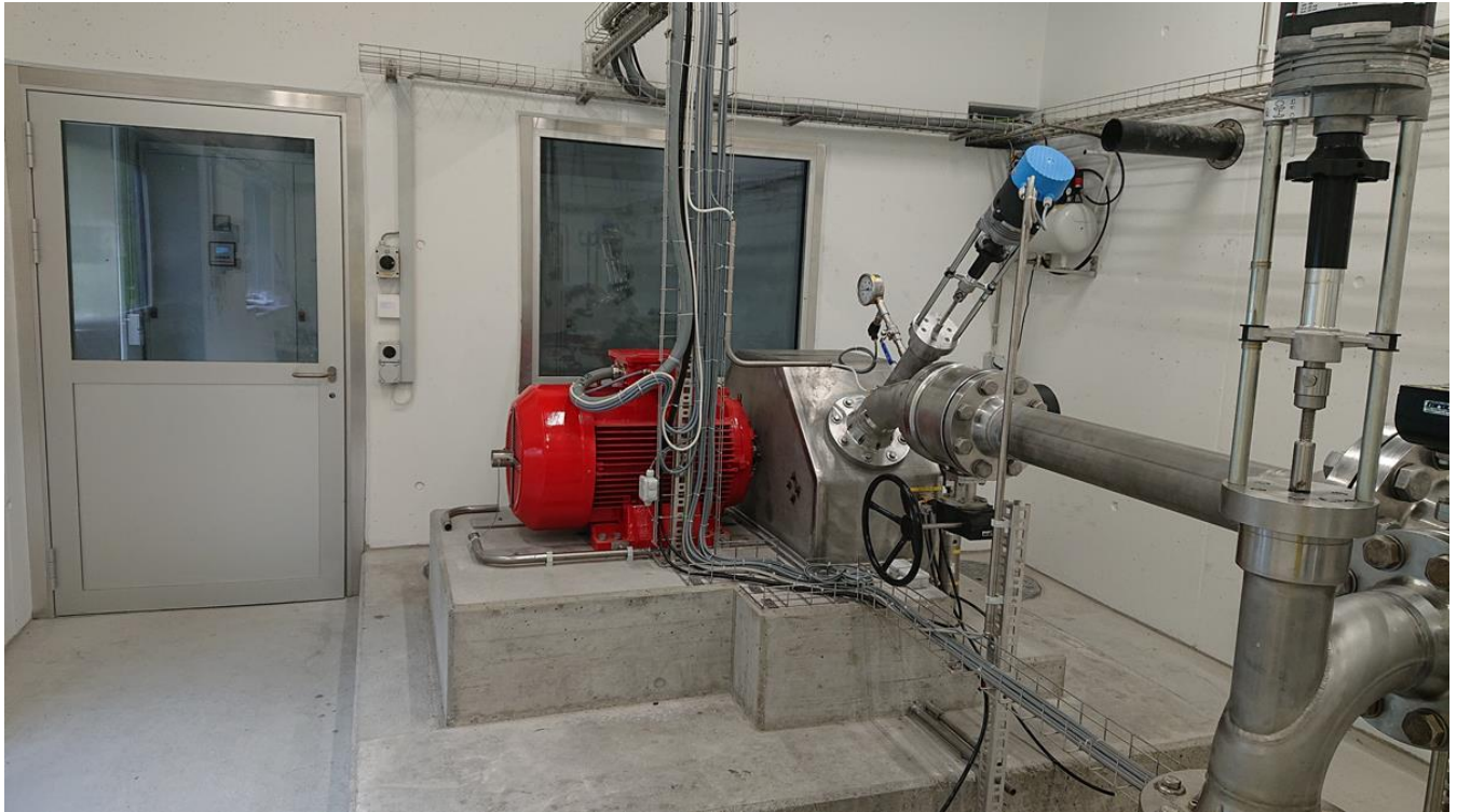
Bild Abwasser Uri: Abwasserturbine und Generator der Druckreduktion in Göschenen (Ableitung Abwässer Urner Oberland). Die Anlage produziert jährlich rund 310'000 kWh Ökostrom.
